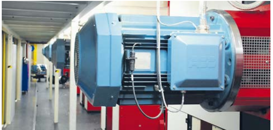
Der Längswellenantrieb wurde entfernt und durch moderne Asynchron-Einzelantriebsmotoren von ABB ersetzt.
